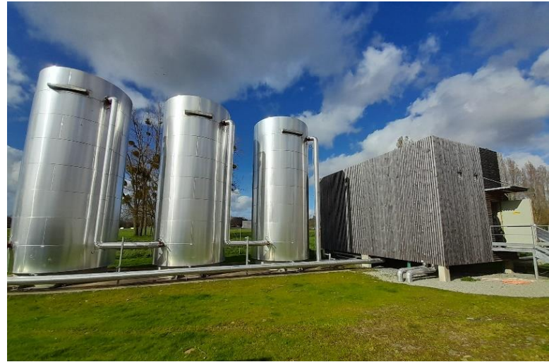
Stockage tampon pour le champs solaire du réseau de Châteaubriand
