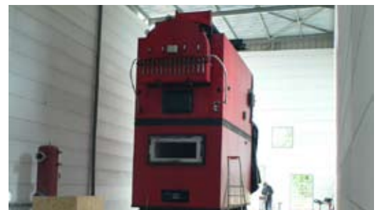
2 Chaudières bois de 3 MW
