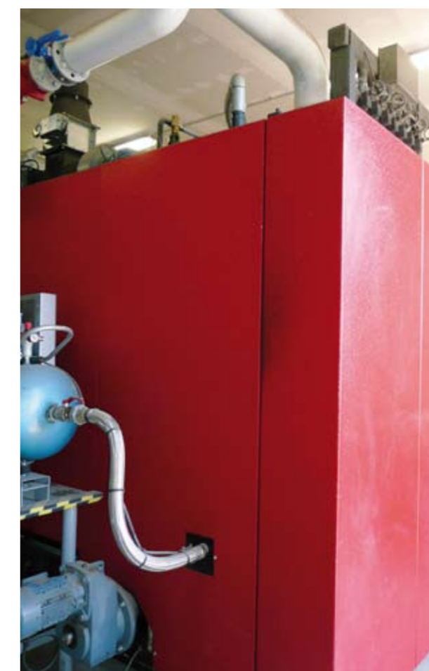
Chaudière au bois.
