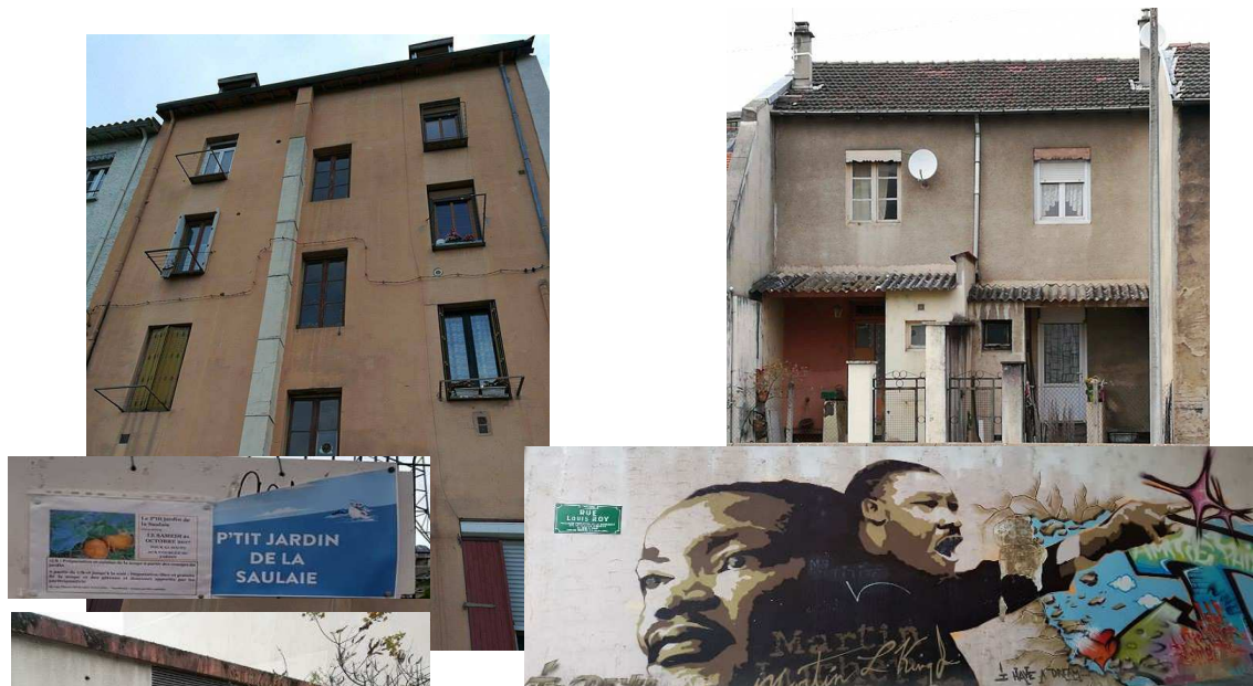
Figures n°3 : Etat du bâti dans le quartier de la Saulaie à l'abord du canal
