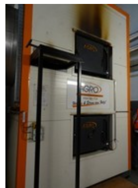
Chaudière bois 1,5 MW
