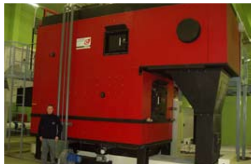
Chaudière à bois 2,5 MW
