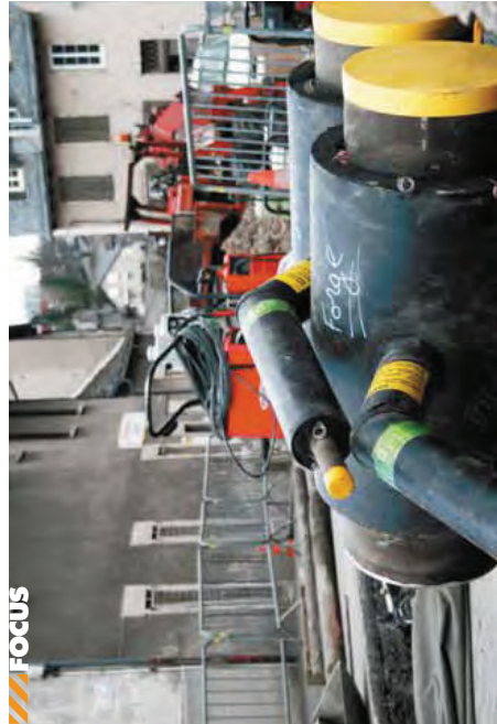
Alimenté par l'usine, un réseau de chaudière spécifique a été installé dans les rues de Mendé.
